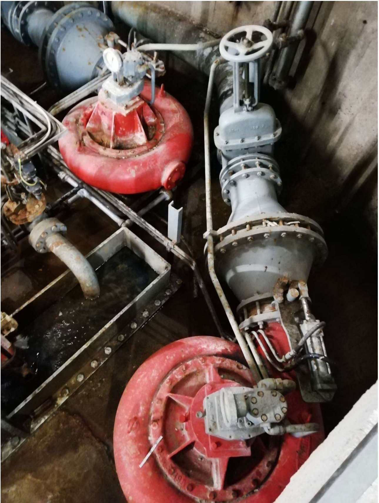
Figura 9 TURBINETTE IN CAMERA DI MANOVRA SCARICO DI FONDO - DA ALIENARE
