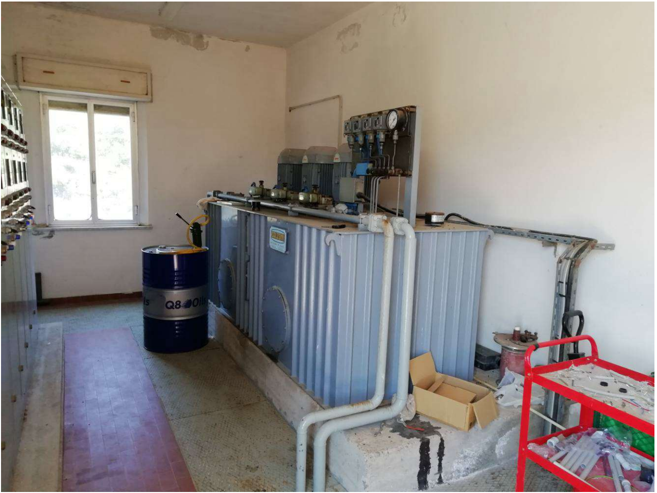
Figura 5 SERBATOIO E POMPE OLIO IN CABINA ESISTENTE - DA ALIENARE
