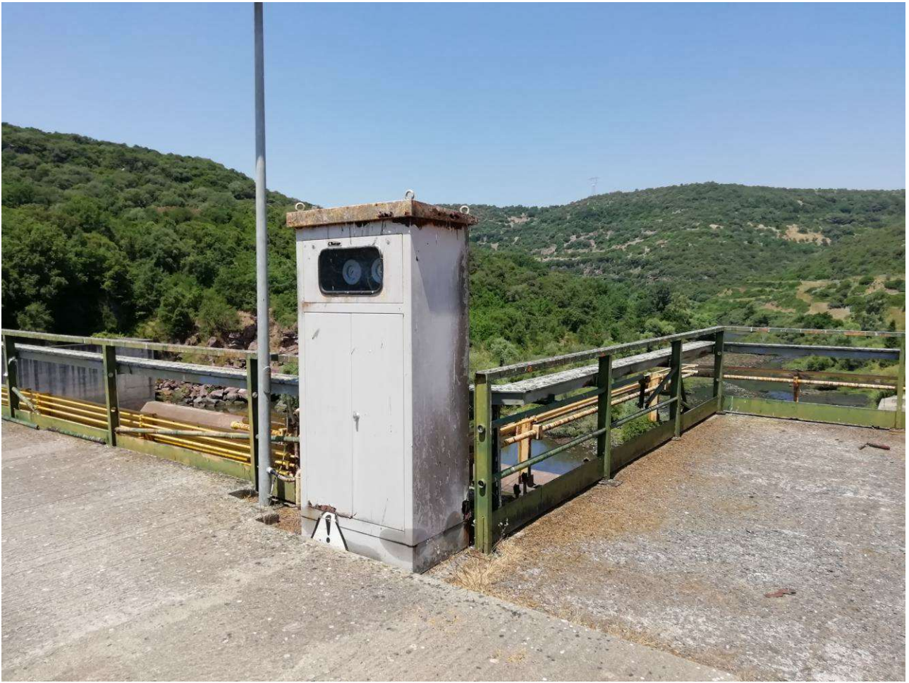
Figura 11 CENTRALINA DI COMANDO LOCALE - DA ALIENARE
