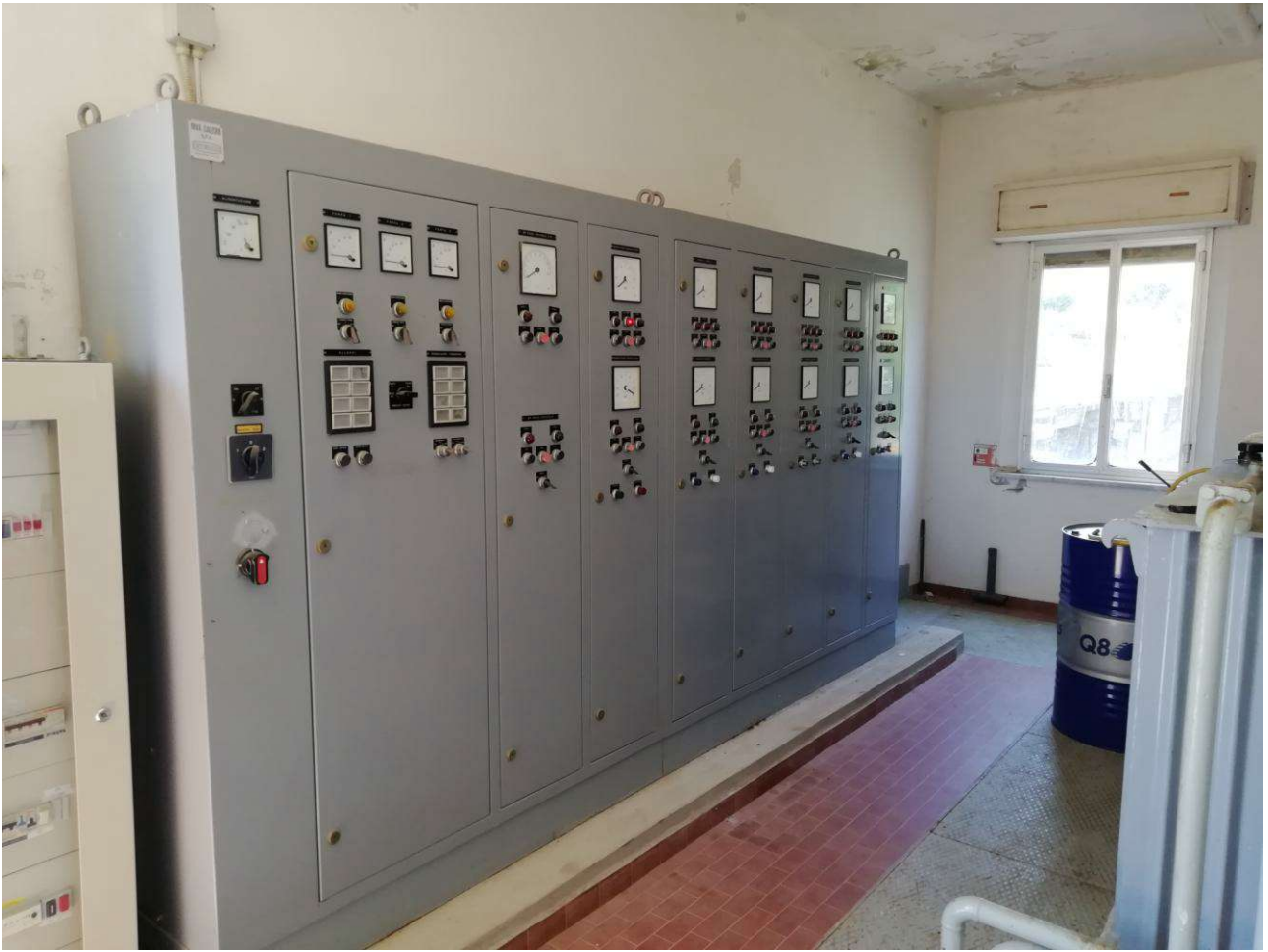
Figura 4 QUADRO DI COMANDO E CONTROLLO - DA ALIENARE
