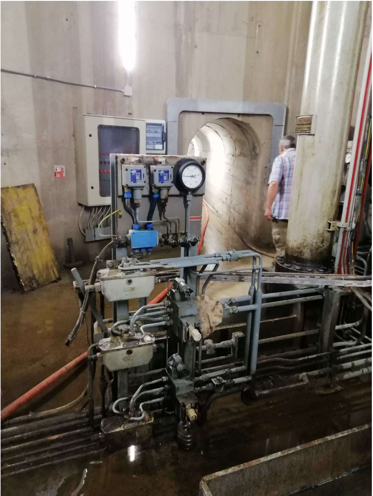
Figura 8 COMANDI LOCALI SCARICO DI FONDO - DA ALIENARE
