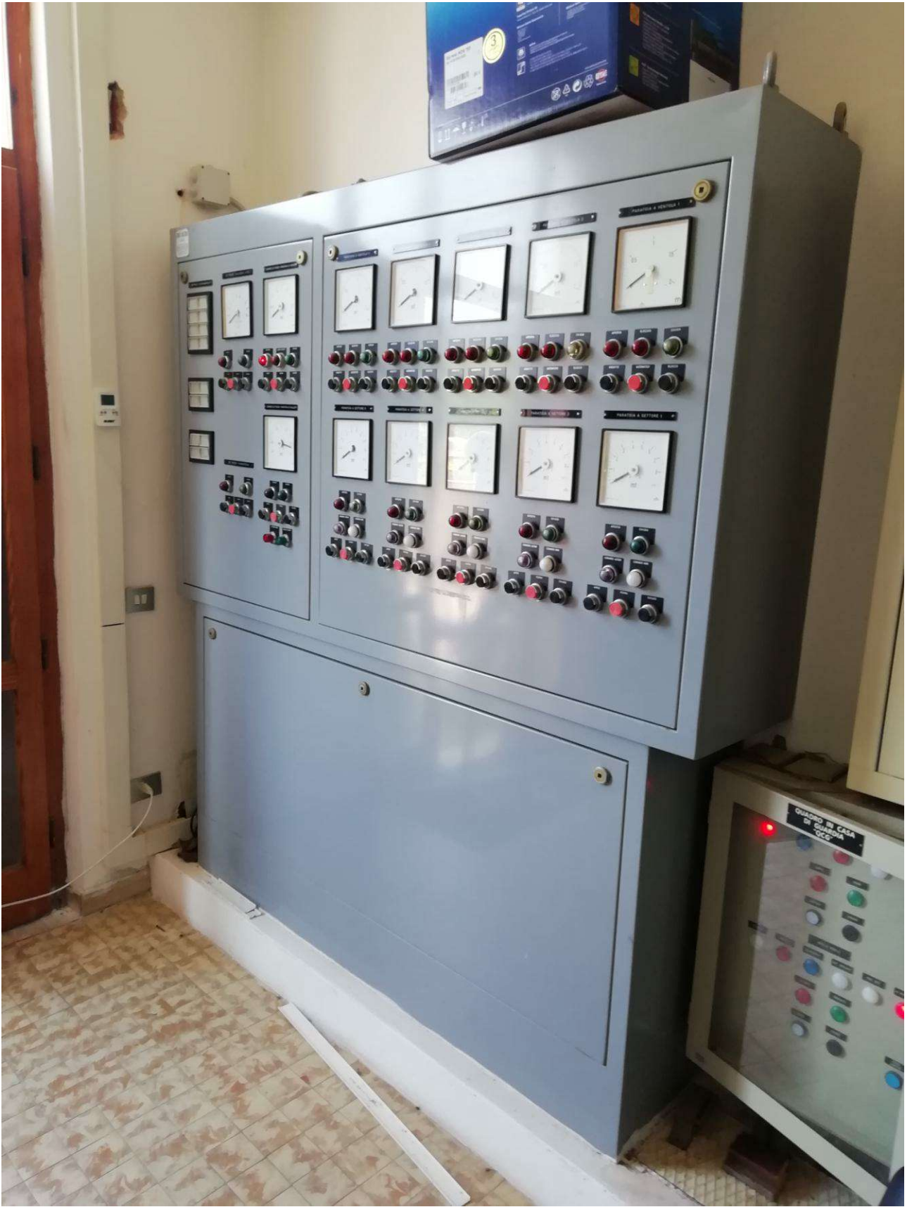
Figura 2 QUADRO CONTROLLO CASA DI GUARDIA - DA ALIENARE
